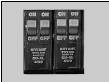
(D) Verify circuit breaker at least 20 amps - if not, move to 20-amp circuit
